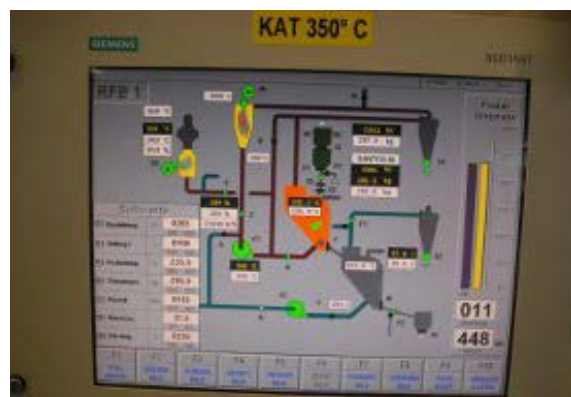
Für jeden Röster zeigt ein Bildschirm genau an, wie weit der Röstprozess für die einzelnen Chargen fortgeschritten ist. Hier für einen RFB-Röster, der im Testbetrieb mit Niedrigsttemperaturkatalysator läuft.
