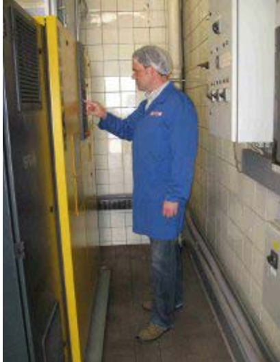
Marc Reckhemke bei der Bedienung der frequenzgeregelten Kompressoren.
